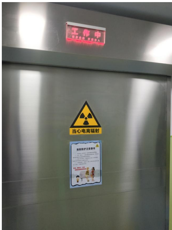
工作状态指示灯、电离辐射警示标志
